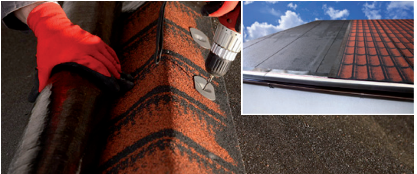
Rozměření a položení pásu RDI 3D® na střechu a zahájení montáže od hřebene.
