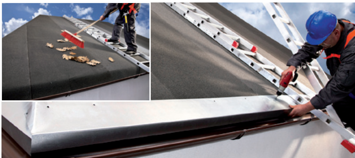
Očištění střechy a montáž oplechování (okapní plechy, střešní svody, závětrné lišty, atd.).
